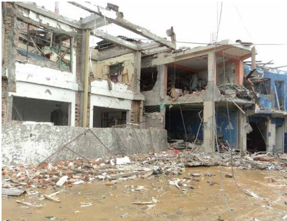
Fotografía 8. Cuartel de la Policía de Tumaco, después de la explosión del primero de febrero de 2012, vista avenida del Ferrocarril. Fuente: Tumacopopolo, 2012.
